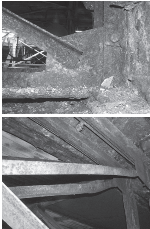
Рис. 2. Деформация элементов вертикальной связи стропильной фермы
