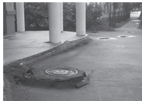
Рис. 2. Повреждение покрытия тротуара из-за неравномерной осадки торфа в основании
