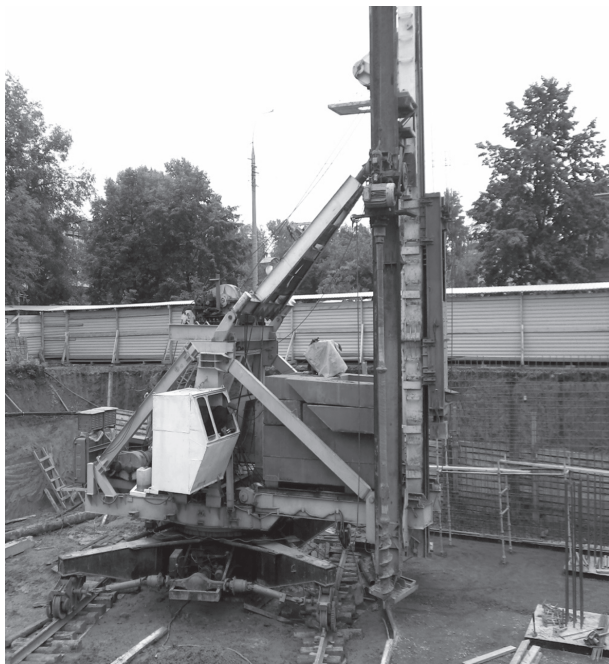
Рис. 1. Общий вид сваевдавляющей установки (СВУ) на строительной площадке в г. Томске по ул. А. Иванова, 2 (май 2014 г.)
