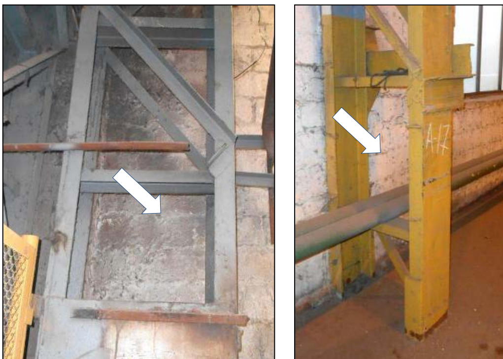
Рис. 3. Металлические колонны с вырезанными элементами соединительной решетки
