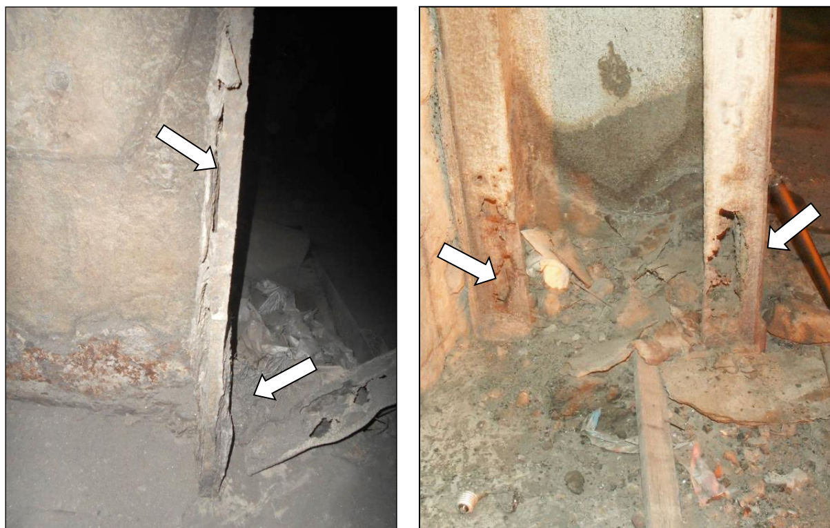
Рис. 2. Слоистая коррозия полок и стенок двутавра колонны (слева), сквозная коррозия металлических уголков колонны (справа)
